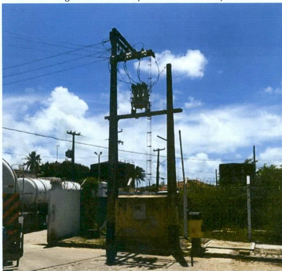
Figura 20 – Distribuição Elétrica e Iluminação
